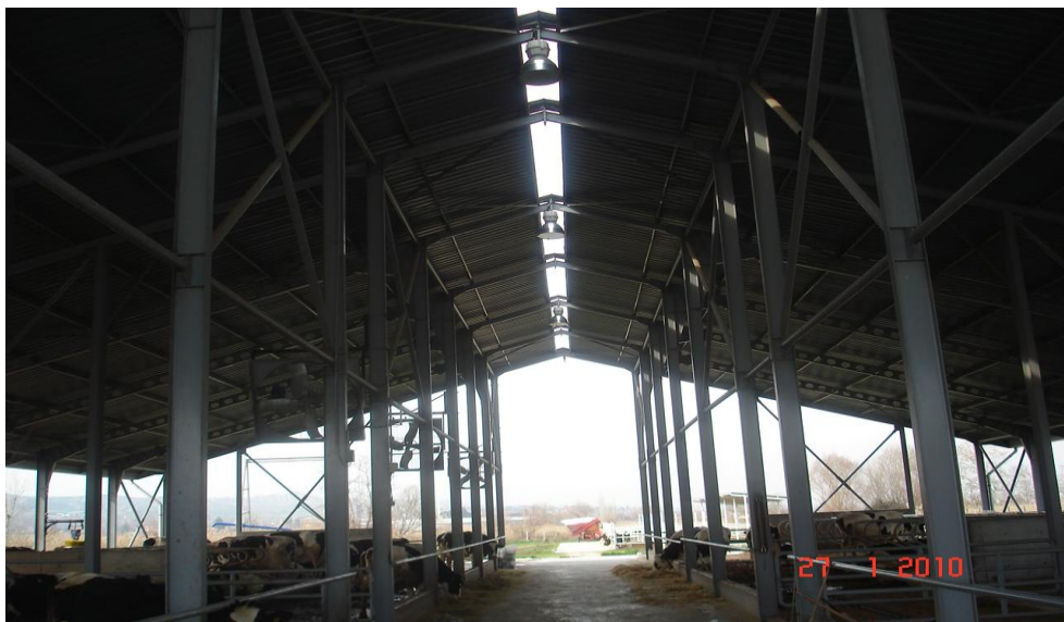
Şekil 4.26. Aydınlatıcı lambaları çatıya monte edilmiş bir işletme (Denizli/Merkez)
