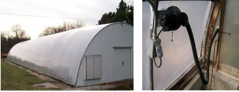
Şekil 1.4. Şişme seraların şişirilmesinde kullanılan fan sistemi
