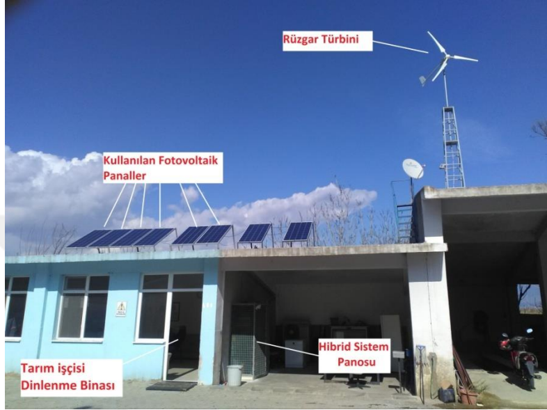
Şekil 3.1. Tarım İşçisi Dinlenme Evi ve Güneş - Rüzgar Enerjisi (Hibrid) Sistemi Genel Görünüşü
