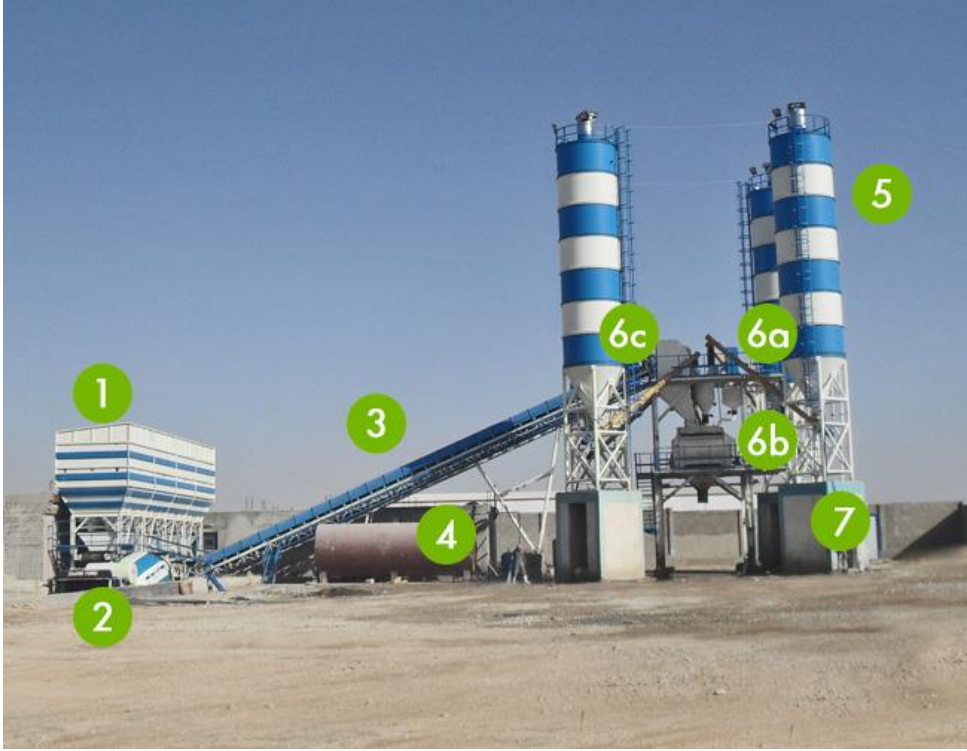
Şekil 3.2. Hazır Beton Santrali
